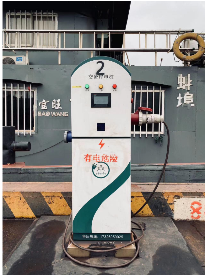
图3.4-11 2#恒润原料码头2号岸电桩
