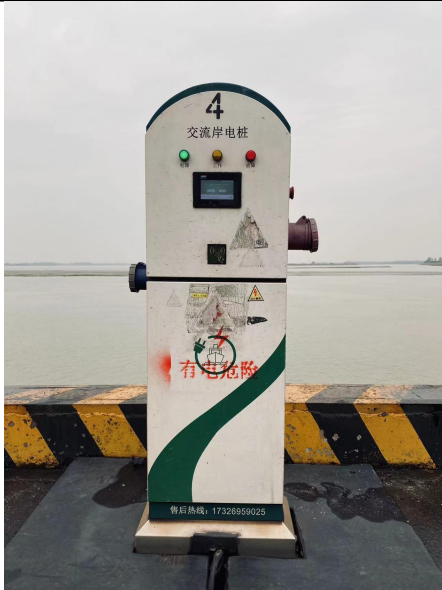
图3.4-13 2#恒润原料码头4号岸电桩
