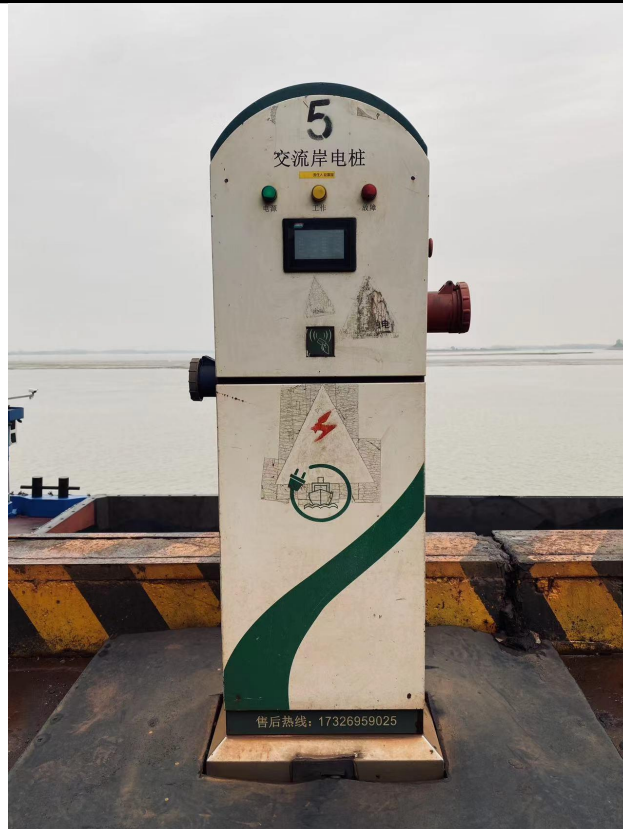
图3.4-14 2#恒润原料码头5号岸电桩
