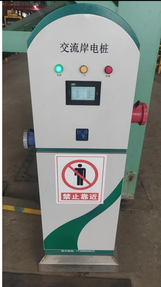
图3.4-25 4#世通成品库外接码头岸电桩
