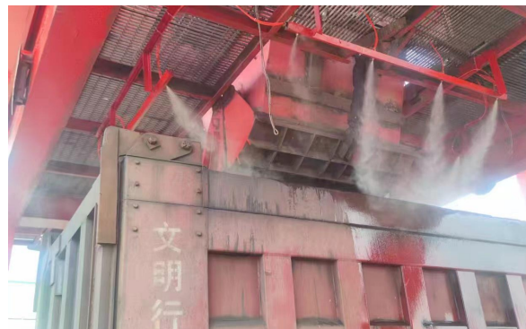
码头区水喷淋设施
