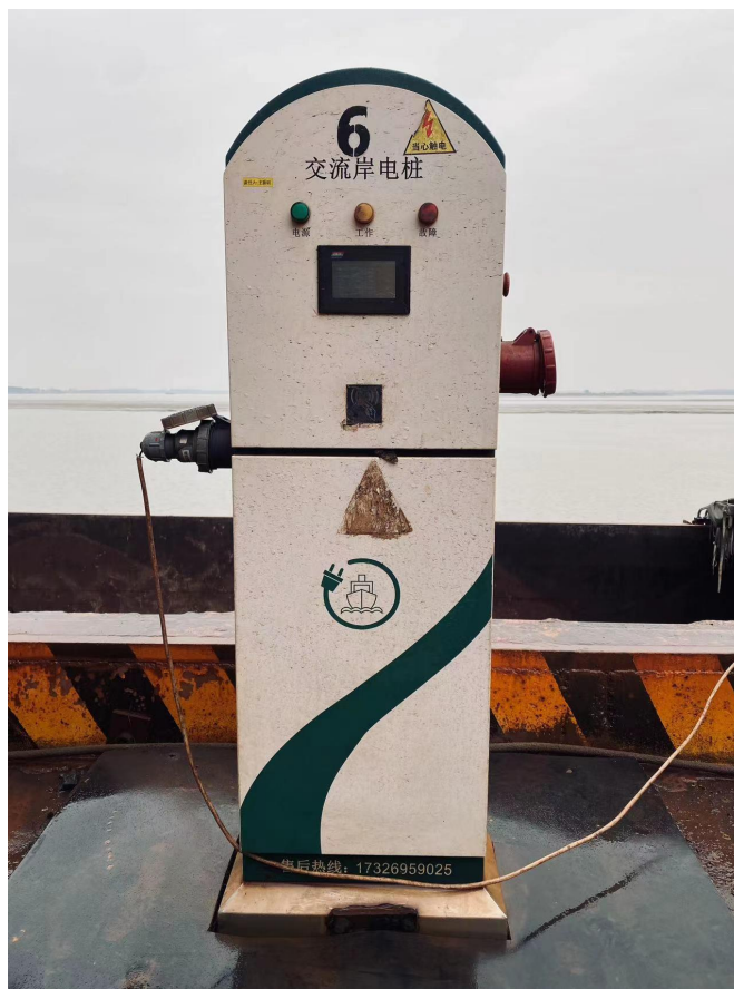
图3.4-15 2#恒润原料码头6号岸电桩
