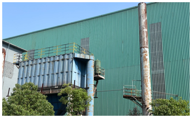
转运站布袋除尘器及排气筒
