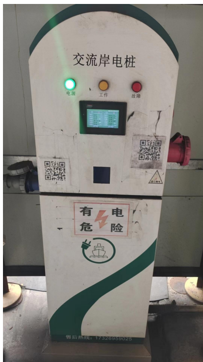
图3.4-21 3#恒润成品库码头2号岸电桩
