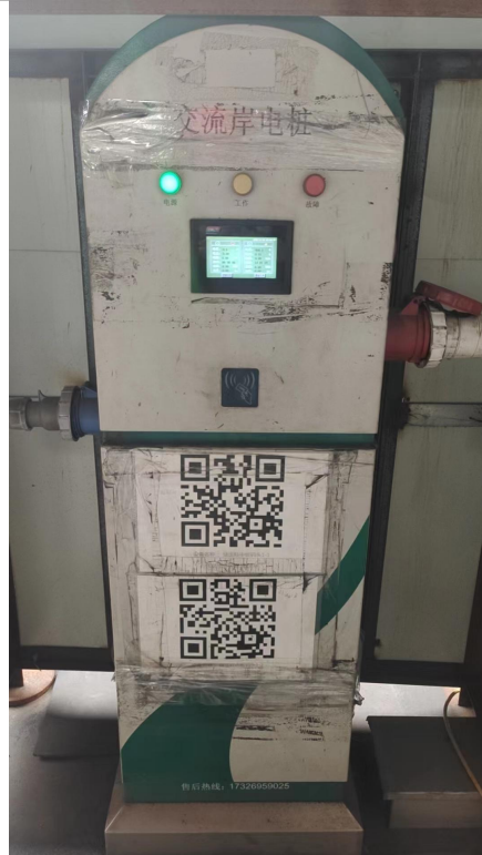
图3.4-20 3#恒润成品库码头1号岸电桩
