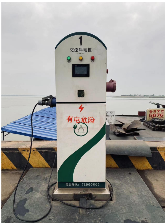
图3.4-10 2#恒润原料码头1号岸电桩
