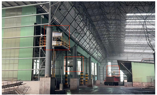
原料堆场内雾炮
