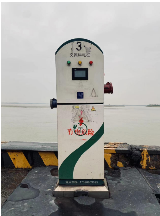
图3.4-12 2#恒润原料码头3号岸电桩
