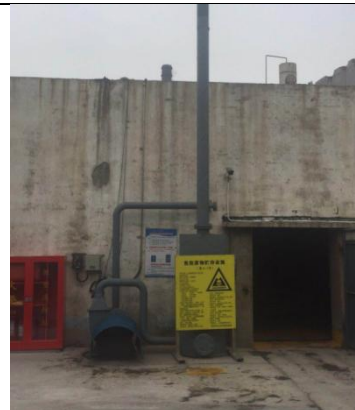
废气处理装置
