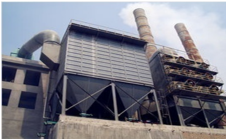
布袋除尘实例照片
